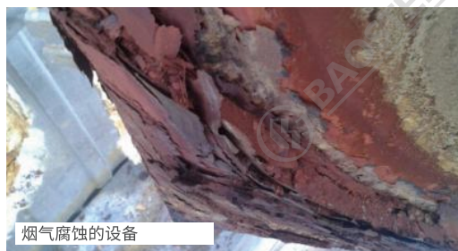
因烟气腐蚀而损坏的厂房
