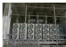
500kV交流变压器 500kV AC transformer
