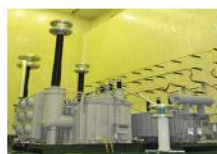
750kV交流变压器 750kV AC transformer
