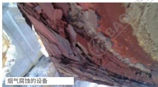
因烟气腐蚀而损坏的厂房
